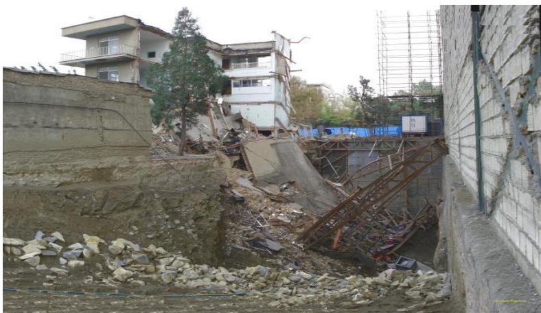
شکل ۱۴: تخریب ساختمان همسایه به دلیل عدم رعایت اصول فنی گود برداری و مهاربندی.
