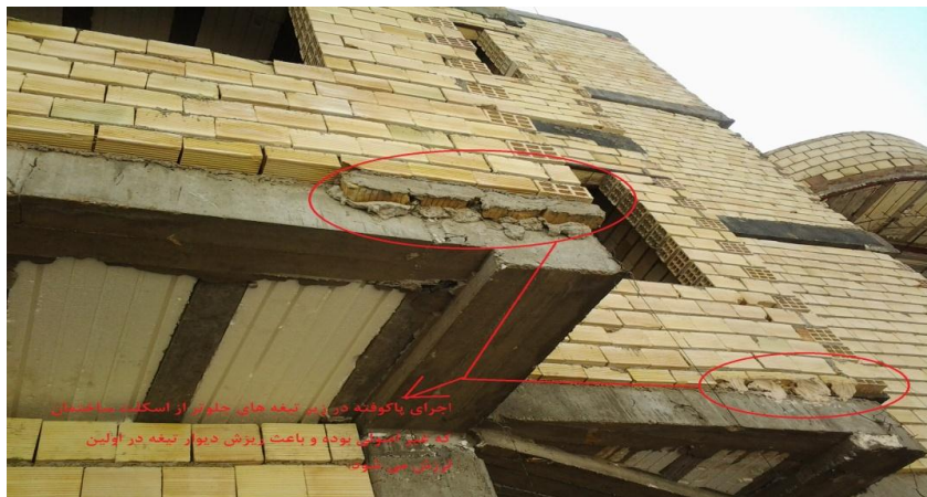
شکل ۱۱: اجرای پاکوفته در زیر تیغه نما جهت اجرای دیوار جلوتر از کف تمام شده و ریزش آن در زمان لرزش و اعمال بار جانبی.
