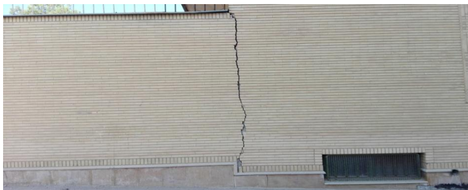
شکل ۷: ترک خوردن محل اتصال دیوار حیاط به دیوارهای اصلی سازه.
