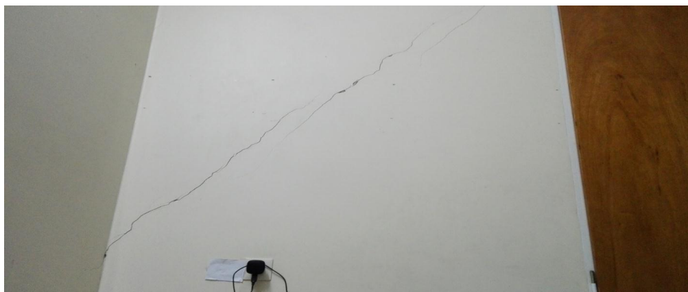
شکل ۶: ترک برشی ۴۵ درجه در تیغه و نازک کاری چسبیده به ستونهای اصلی.
