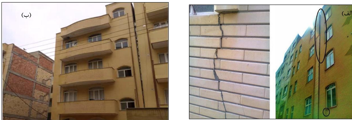
شکل ۶- نمونه‌ای از سازه‌های آسیب دیده با پی سطحی در شهر تبریز: (الف) سازه کج شده در کوی فرشته و تصویری از ترک‌های نمای ساختمان [۲۳]، (ب) سازه کج شده در کوی شرکت گاز [۱۱].
