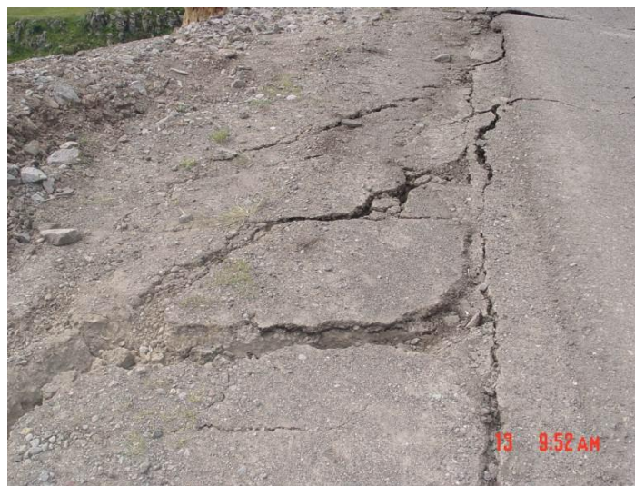
شکل ۳: ترک خوردگی زمین [۱۷].
