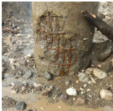
شکل ۲۱: خوردگی پایه پل مدل آزمایش.
