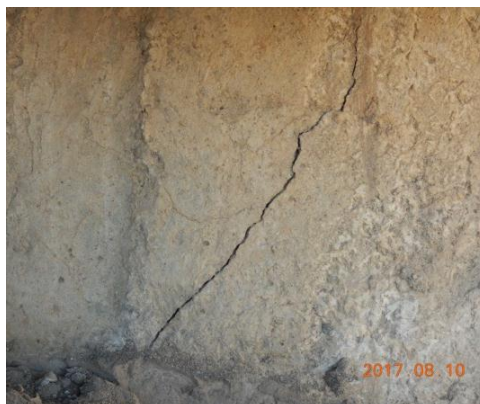
شکل ۲۲: ترک برشی پایه پل مدل آزمایشگاهی.
